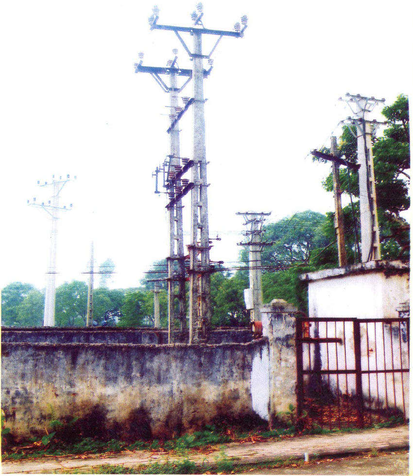
Trạm biến thế điện xây dựng 1970
